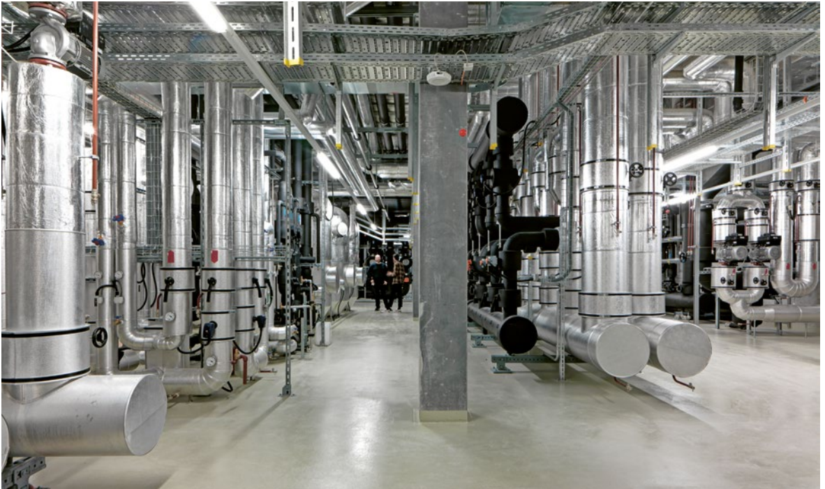
Technikzentrale Heizung/Kälte des Spitals Limmattal – EKZ hilft, die immer komplexere Technik in Spitälern effizient zu planen und umzusetzen
